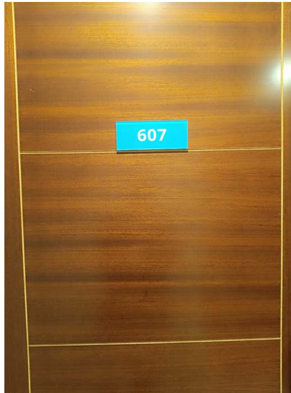
DETALLE CONCRETO DE LA PUERTA DE ACCESO DEL APARTAMENTO OBJETO DE AVALUO.
